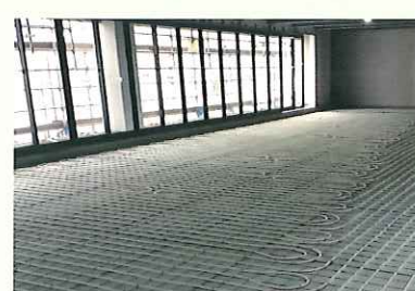
躯体蓄熱床(敷設面積合計 500m²)
